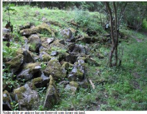
Nedre deler av anlegg har en flomvoll som ligger på land.
