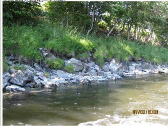
Nedre deler av anlegg som er skadet.
