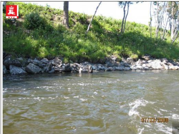
Midtre deler av anlegg som er skadet.
